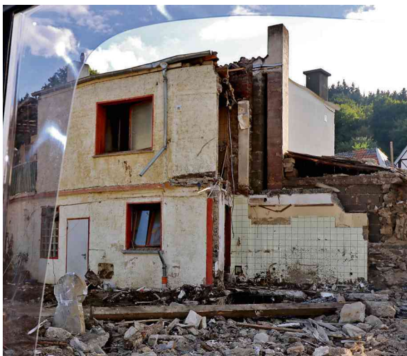
Wie Krieg, nur ohne Bomben aber mit über 130 Toten allein an der Ahr. Fast alle flussnahen Anlieger, hier oberhalb von Bad Neuenahr/Ahrweiler, können noch lange nicht wieder ihre kaputten und durchnässten Häuser bewohnen.
